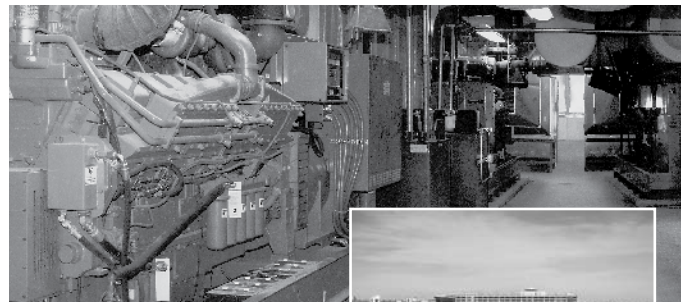
Cuatro grupos electrógenos de 1500 kW de Cummins Power Generation suministran la energía de respaldo en la terminal principal del Aeropuerto Internacional de Minneapolis-St. Paul.
